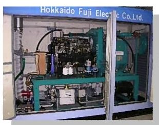
ガス発電機内部
