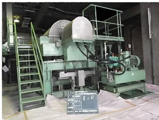
遠心脱水機 (更新前)
