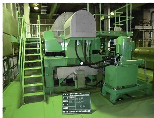
遠心脱水機 (更新後)
